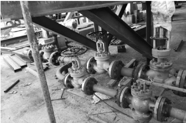
(c) 焚烧间13.5m层高压给水管道操作阀组
