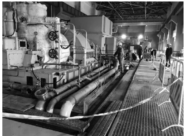
(a) 汽机间8.5m层润滑油管道
