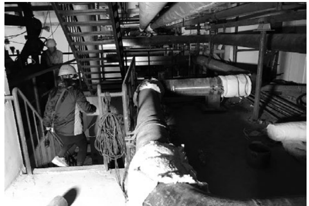
(f) 汽机间4.5m层主蒸汽管道
