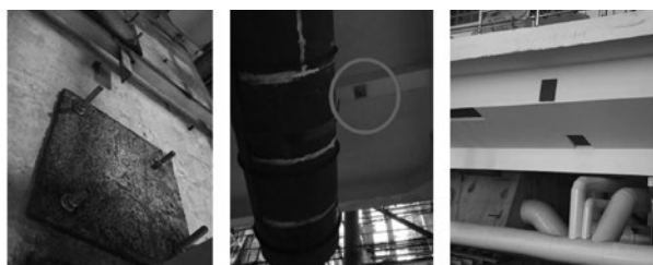
图2 施工现场预埋件问题图
